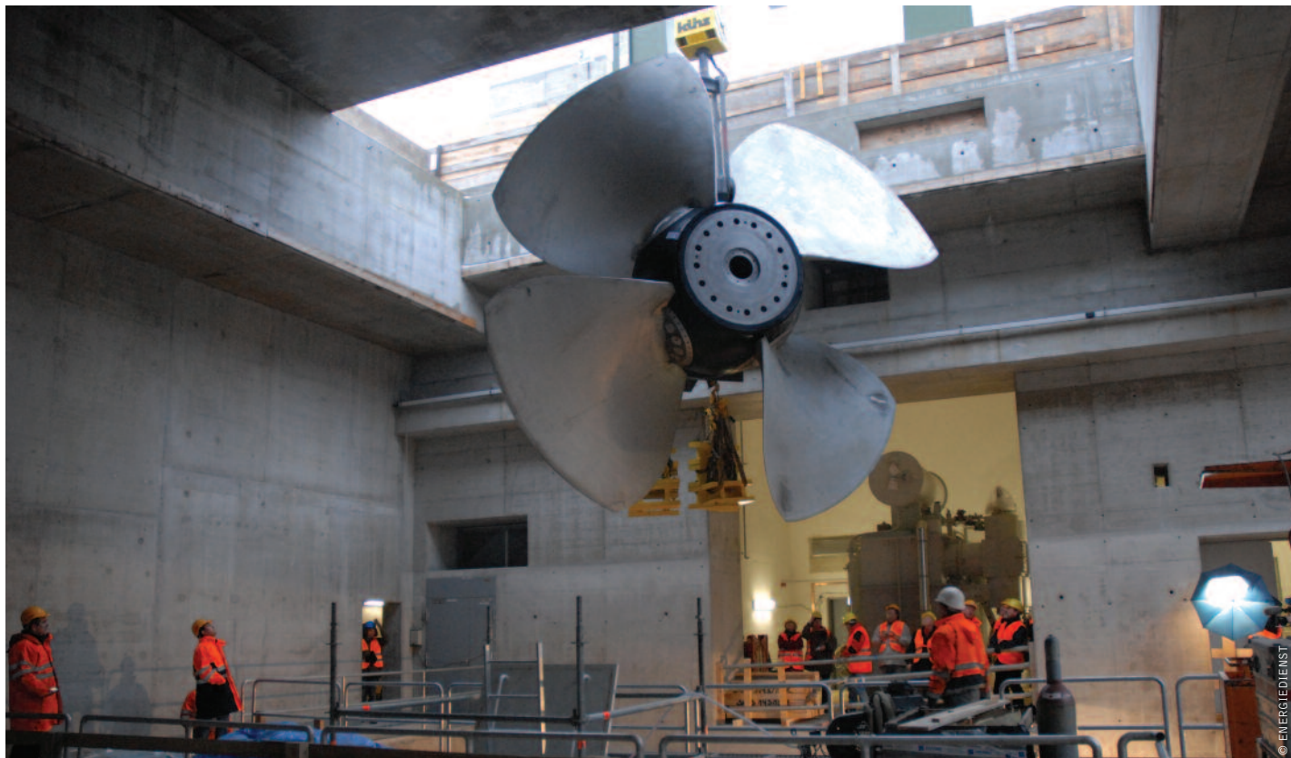
bild EINBAU EINES LAUFRADS IM FLUSSKRAFTWERK RHEINFELDEN, DAS SEIT 2010 STROM FÜR 42'000 HAUSHALTE LIEFERT, IM FLUSSKRAFTWERK RHEINFELDEN. INSGESAMT PRODUZIERT DAS KRAFTWERK STROM FÜR RUND 170 000 HAUSHALTE JÄHRLICH.
