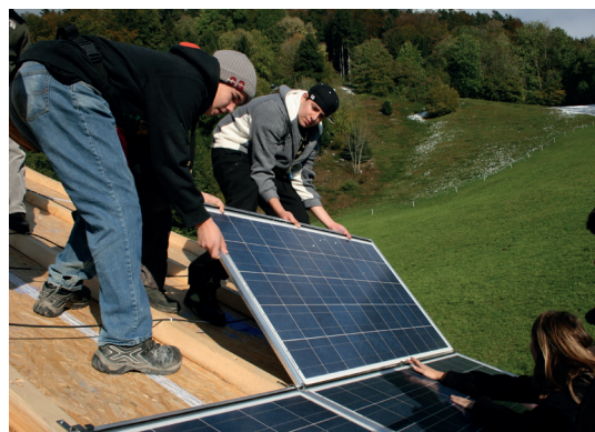
Dans le cadre du Projet Jeunesse Solaire les jeunes installent 550 mètres carrés de panneaux photovoltaïques sur le toit d'une ferme à Oberdorf, Schwyz. © Greenpeace
